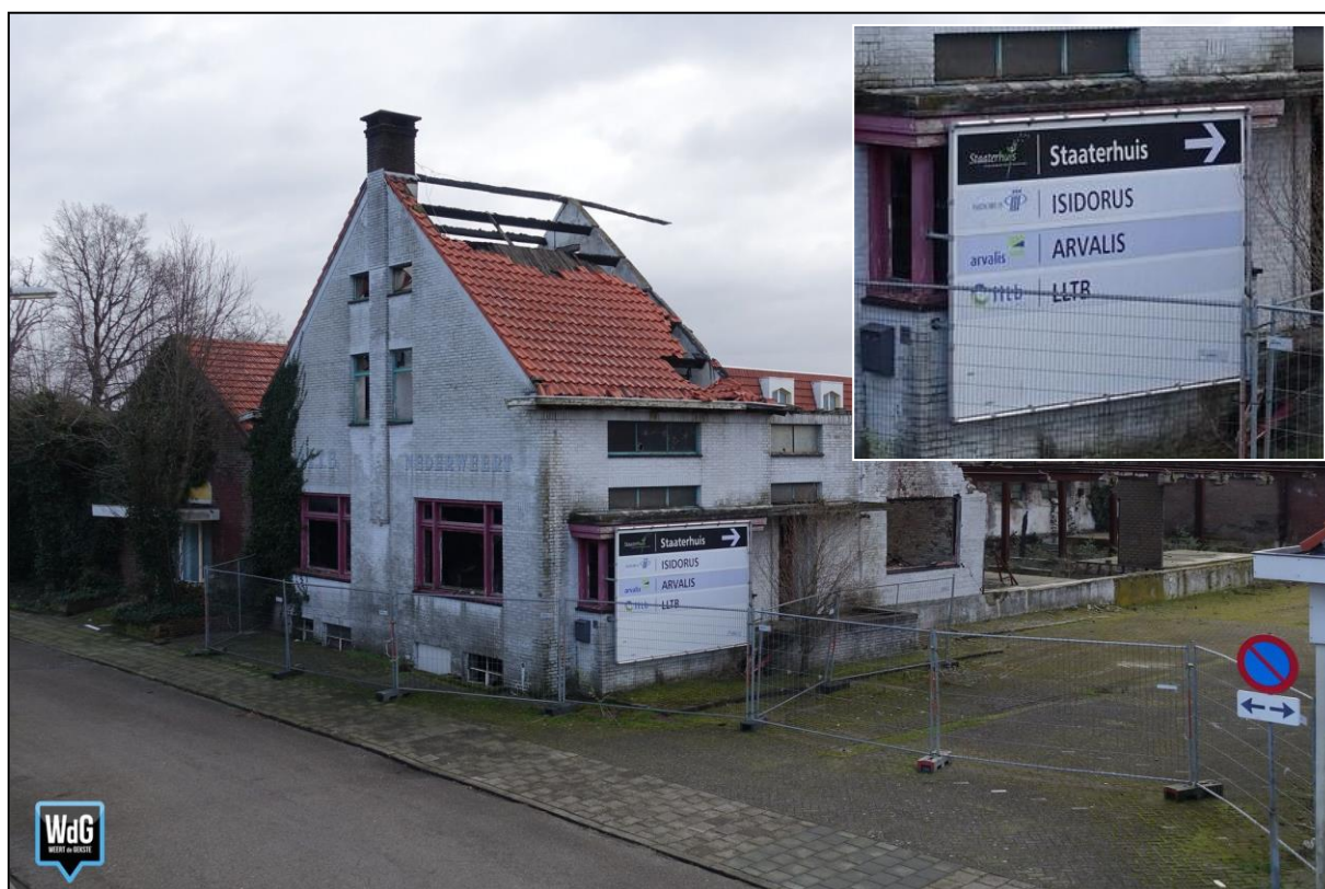
Fig. 2. Bedrijvent centrum Staaterhuis na de fatale brand van de voormalige Boerenbond in 2013. Met inzet van het naambord. Foto: WeertDeGekste.
