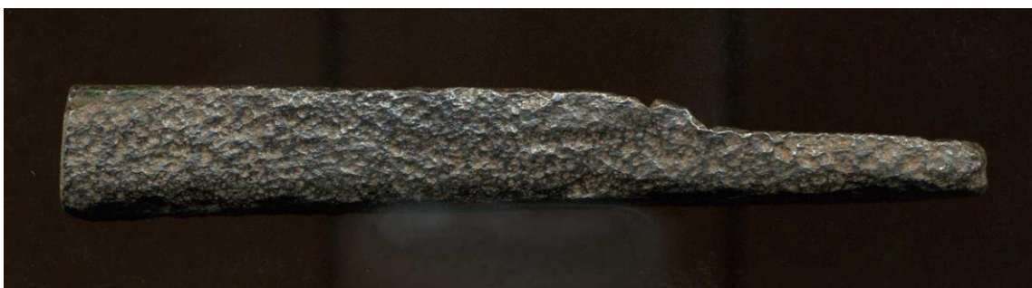
Fig 14 en 15. Boven- en zij-aanzicht van het uiteinde van een tijdens de brand gebroken schieter van een muuranker met dubbele Andreaskruisversiering (1750). Foto's: Alfons Bruekers.
