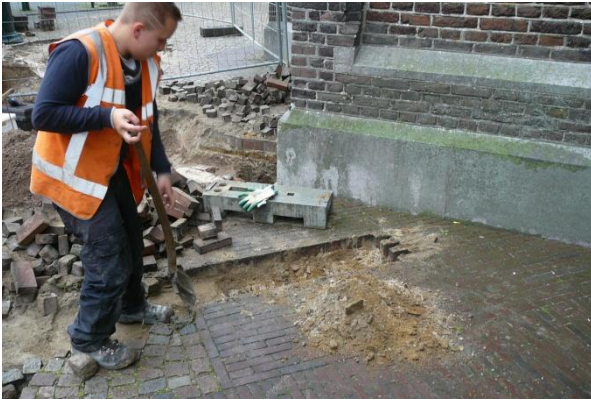
Figuur 50. Aanleg van een zoek sleuf aan de zuidkant van de hoektoren.
