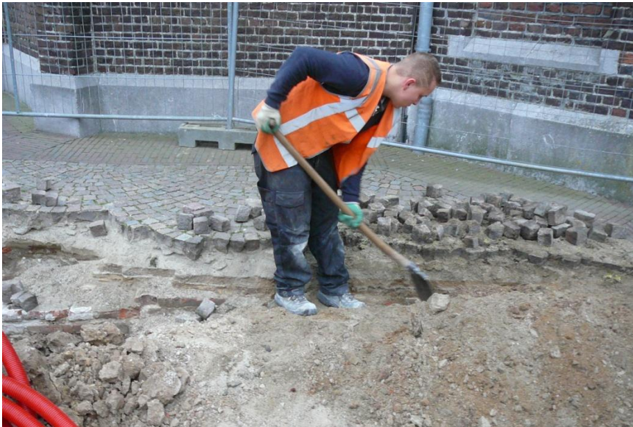
Figuur 403. Medewerker van fa. Bloem maakt een aanvang met het vrijleggen van het funderingsspoor
