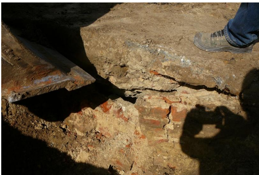
Figuur 19. Het betondeksel was gestort op baksteenrand. Verwijdering ging niet zonder lichte beschadiging van het metselwerk van de put.
