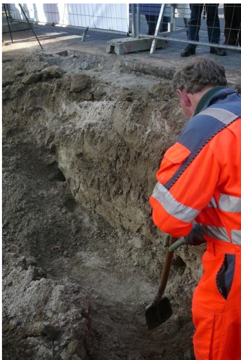
Figuur 15. Vondst van onregelmatig gestort betondeksel, dat na verwijdering de afdekking van een waterput bleek te zijn.
