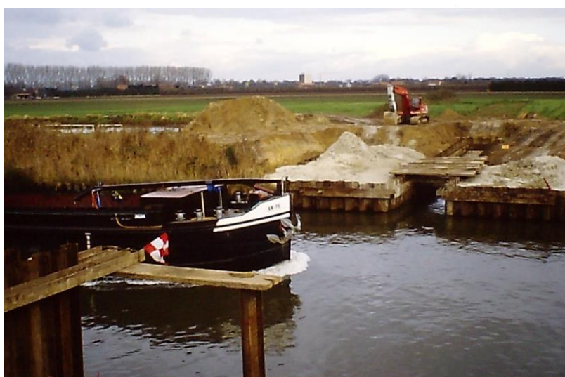
Figuur 6. Zicht op de oostoever, vanaf de westoever. Voorbereiding voor het leggen van de zinker van het persriool. Foto Alfons Bruekers.
