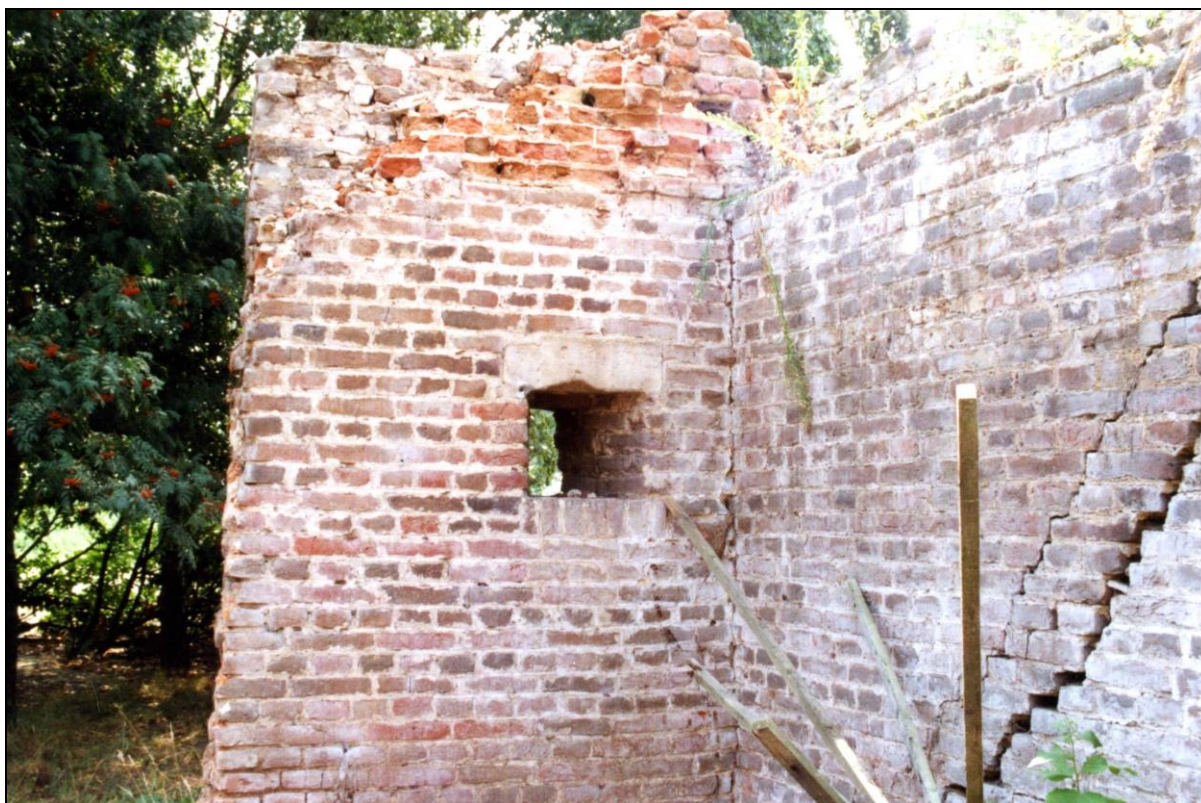
Figuur 21 De binnenzijde van de schuur met scheurvorming ten gevolge van het verzakken van de gevel. Op de foto zien we ook een schietgat dat wijst op de oorspronkelijke verdedigbaarheid van deze hoeve. Foto A. Bruekers, 2001.
