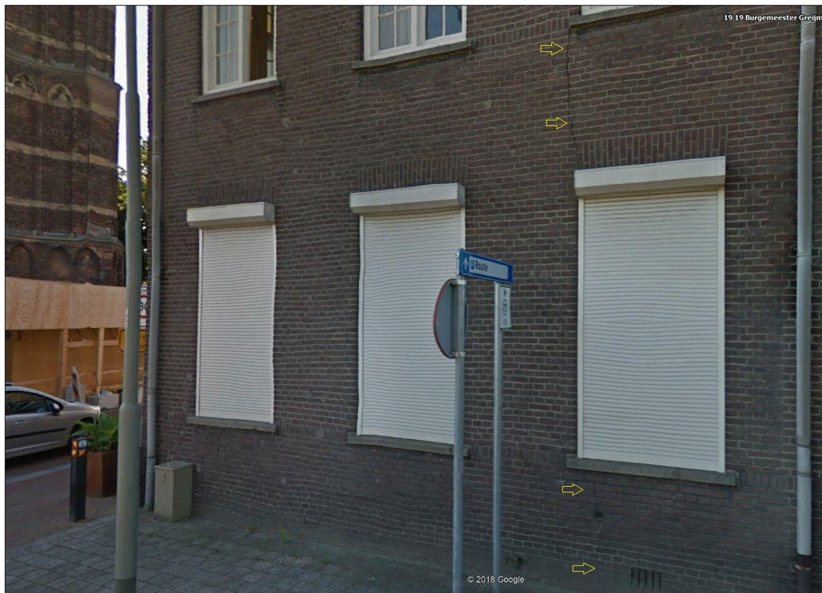
Fig. 20. Dilatatiebreuk (bij de gele pijlen) in het opgaande muurwerk van de noordhoek van het gemeentehuis (burg. Greijmansstraat). Foto: Google Earth 2018.
