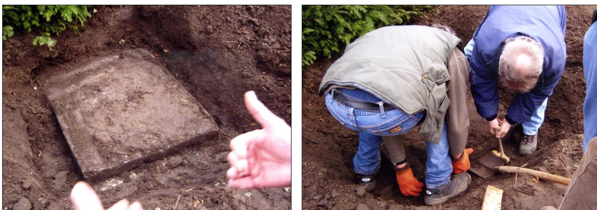
Fig. 3 en 4. De betonnen afdekplaat en het lichten ervan. Alle foto's: Alfons Bruekers.
